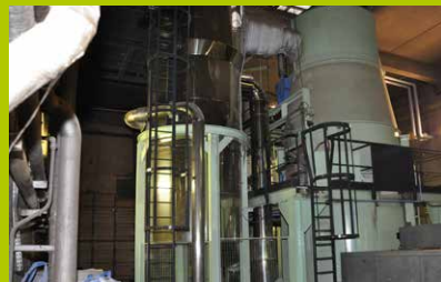
L'incinérateur à boues
